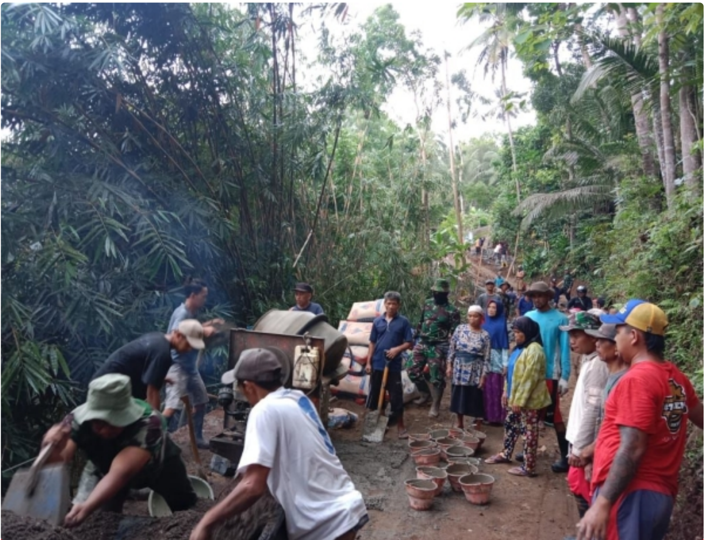
Babinsa Koramil 22/Ayah Serma Tugino bersama warga Giyanti bahu membahu membangun talud penahan bahu jalan
